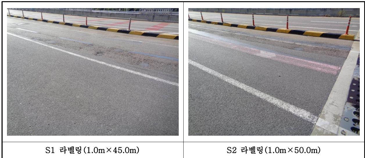
【사진 1.3.20】 교면포장 손상현황
